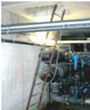
Ambiente assimilabile: locale tecnico piscine
